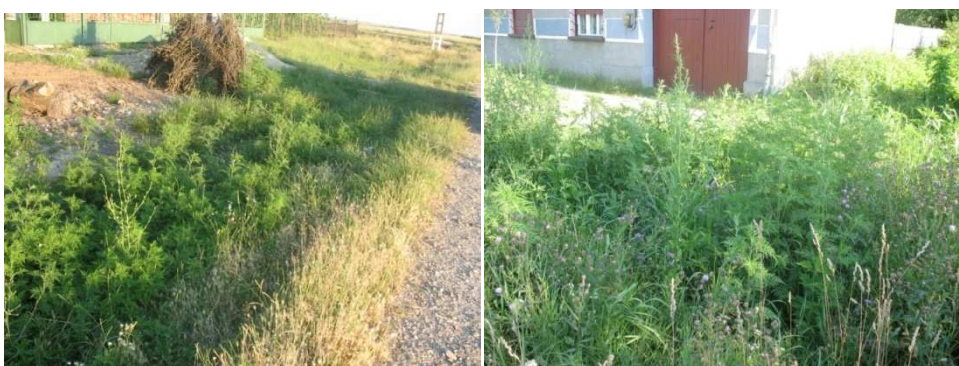
Fig.9. Șanțuri de drenare invadate, Bacova și Jena, iulie 2008
